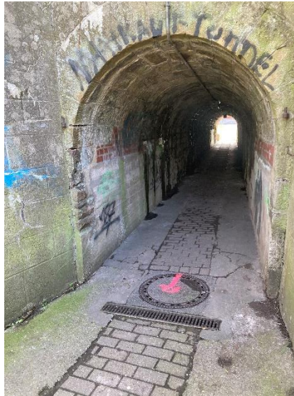
Funktionale und gestalterische Missstände Fußwegeunterführung Hauptstraße bzw. Bahntrasse
