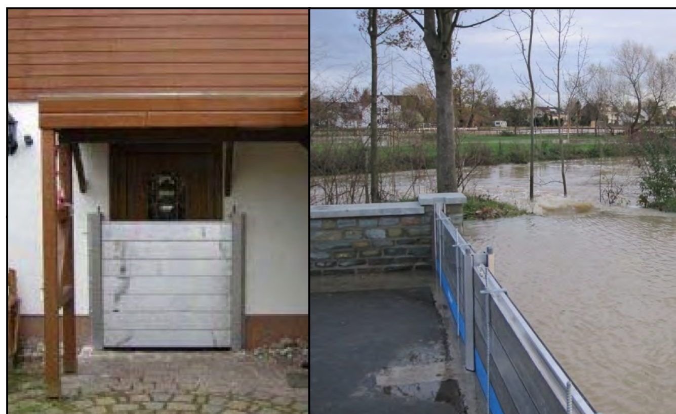
Dammbalkenverschluss Gebäude / Straße
