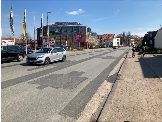
Schaffung von Querungsmöglichkeiten an der Hauptstraße – mangelhafte Nebenanlagen
